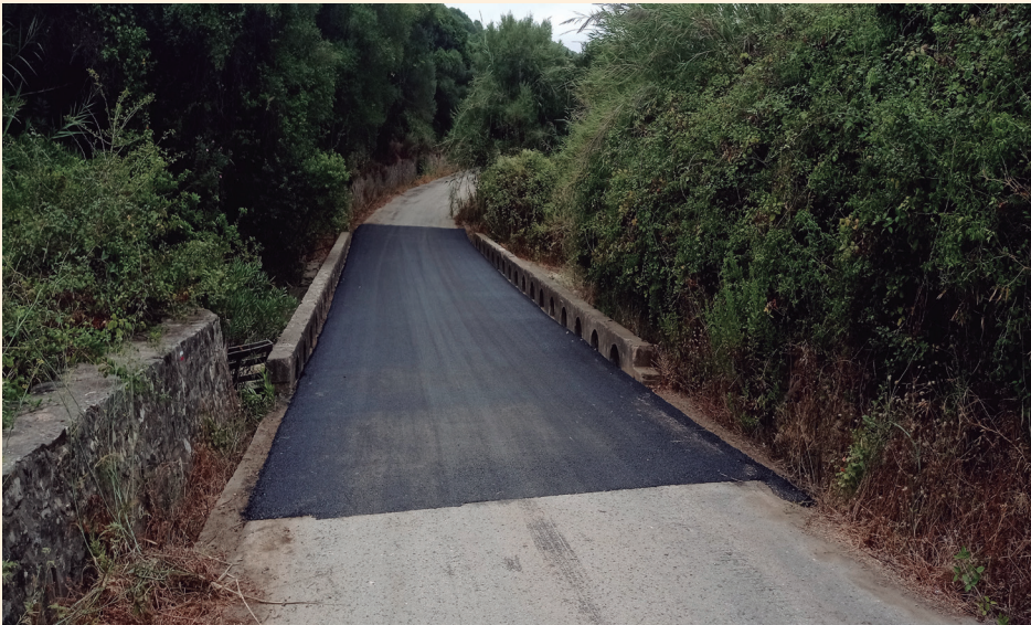
Tramo asfaltado del puente sobre el arroyo del Lobo, el más peligroso debido a su gran socavón.
